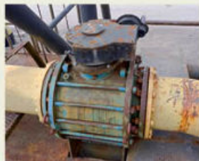
Figura 4.31 Tubería de petróleo afectada por el proceso de la corrosión.
