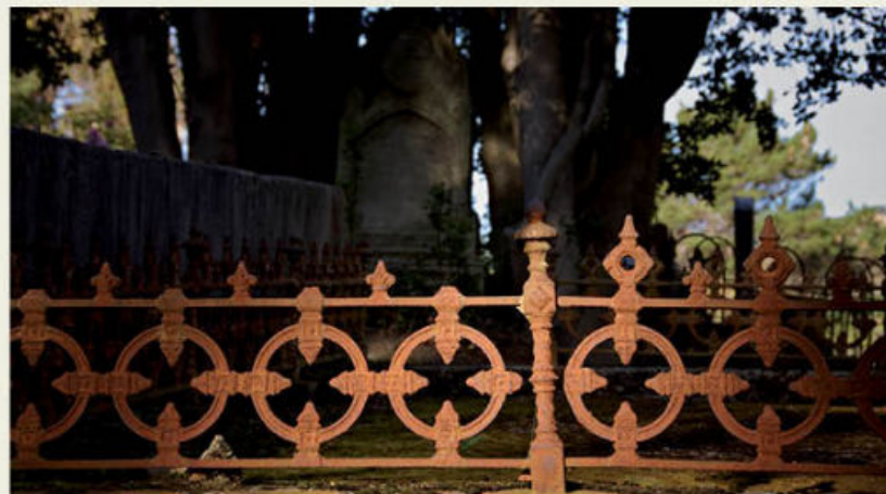
Figura 4.33 Estructura metálica afectada por la corrosión.
