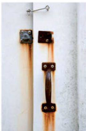
Figura 4.19 Puerta metálica corroída y con claras muestras de herrumbre.
